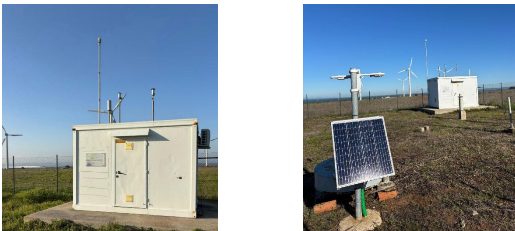
Figura 4 – Estação de Monitorização de Monte Chãos
